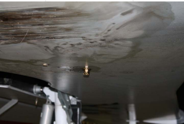
Fig.5 Valva purjare / golire rezervor combustibil
